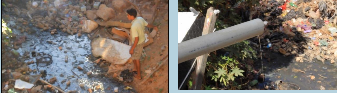
Lançamento de esgotos à céu aberto em Manoel Dias Branco – Fortaleza/CE.
