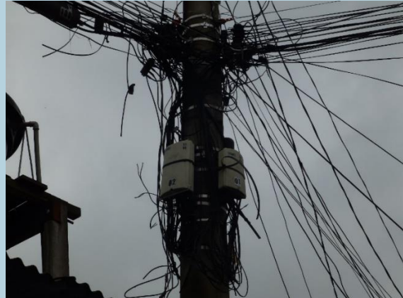
Conexão de energia clandestina na comunidade Santa Cruz dos Navegantes em Guarujá/SP.
