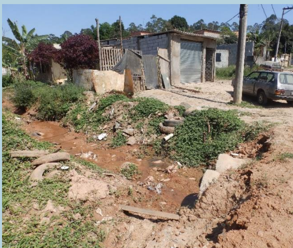
Lançamento de esgotos em córregos – Jardim Canaã/ Itaquaquecetuba/SP.
