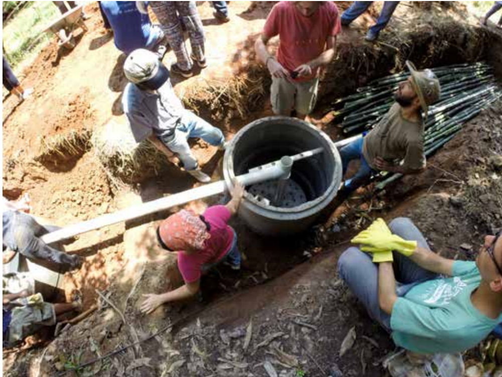
Figura 3 – Implantação do sistema de tanque séptico, filtro anaeróbico e vala de bambu
